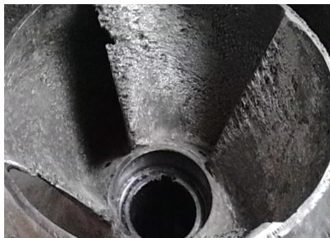
图 1 离心水泵运行 1 年后的磨蚀形貌
